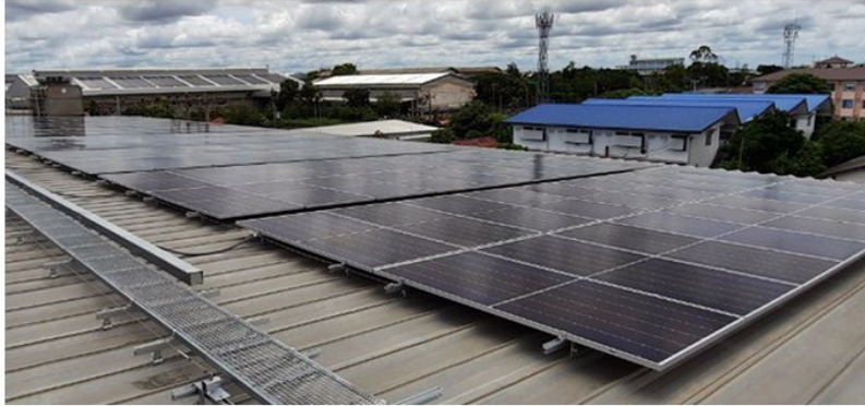
บริษัท ไทยเอ็กซ์เซลพลัส จำกัด จังหวัดสมุทรปราการ Capacity : 250 kWp Solar Rooftop
