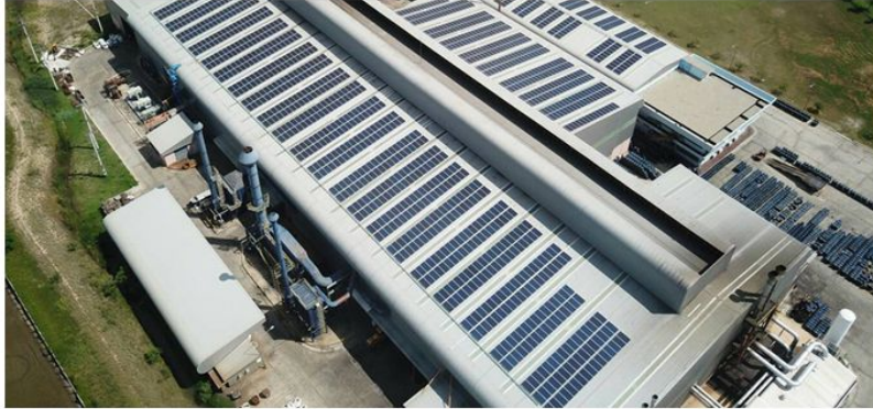
บริษัท มากอดโต้ จำกัด จังหวัดสระบุรี Capacity : 440 kWp Solar Rooftop
