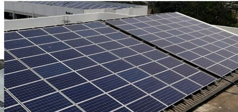
โรงพยาบาลศรีสวรรค์ประชารักษ์ Capacity : 200 kWp Solar Rooftop
