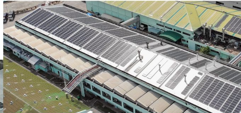
บริษัท ไทยพรสิริภัณฑ์ จำกัด (มหาชน) จังหวัดลำพูน Capacity : 1 MWp Solar Rooftop
