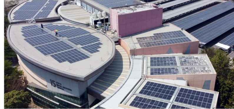
มหาวิทยาลัยรังสิต หอพักอาคารและลานจอดรถ อาคาร15 คณะวิทยาศาสตร์ Capacity : 990.60 kWp Solar Rooftop
