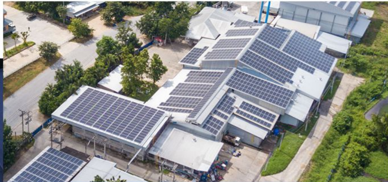
บริษัท เอส เค อินเตอร์ พาวเวอร์ จำกัด จังหวัดตาก Capacity : 536 kWp Solar Rooftop
