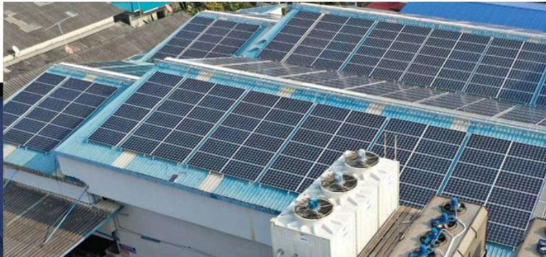
บริษัท ไทยน้ำแข็งหลอด จำกัด จังหวัดกรุงเทพมหานคร Capacity : 300 kWp Solar Rooftop
