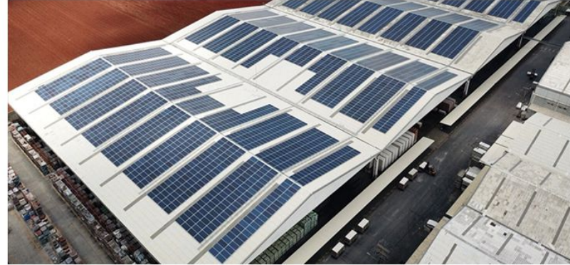
บริษัท เนอรา จำกัด (มหาชน) จังหวัดลพบุรี Capacity : 4.99 MWp Solar Rooftop
