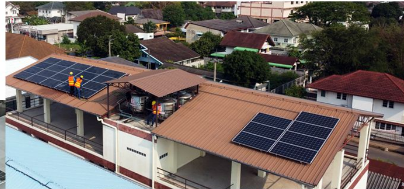
ฟาร์ม อพาร์ทเมนต์ จังหวัดนนทบุรี Capacity : 10 kWp Solar Rooftop
