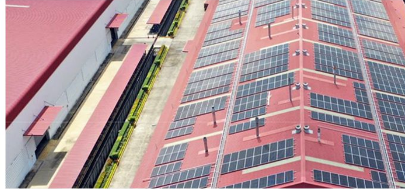
บริษัท แมชเทค อินเตอร์เนชั่นแนล จำกัด จังหวัดเชียงใหม่ Capacity : 1 MWp Solar Rooftop
