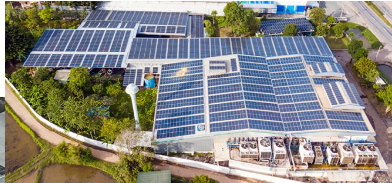
บริษัท เอลฟ์ โย บาสเตอร์ จำกัด จังหวัดสมุทรปราการ Capacity : 1.69 MWp Solar Rooftop
