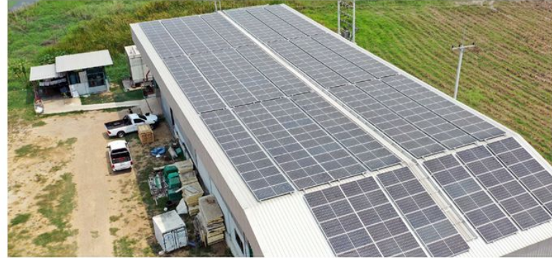
บริษัท โพธิ์ทอง โอซ์ 2016 จำกัด จังหวัดอ่างทอง Capacity : 300 kWp Solar Rooftop
