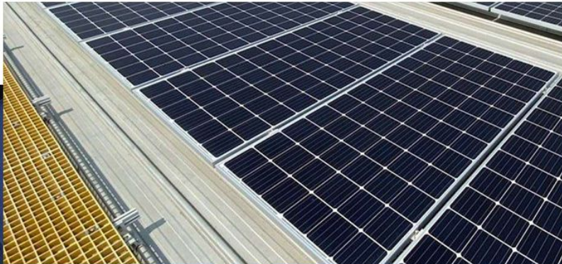
บริษัท ไทยคุณเงิน จำกัด จังหวัดสมุทรปราการ Capacity : 1 MWp Solar Rooftop
