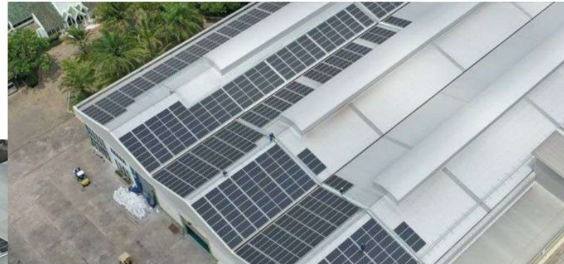
บริษัท ดิโกเดอร์ บม จำกัด จังหวัดชลบุรี Capacity : 309.6 kWp Solar Rooftop
