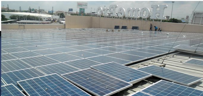
โอบีเอส ราชพฤกษ์ Capacity : 1 MWp Solar Rooftop
