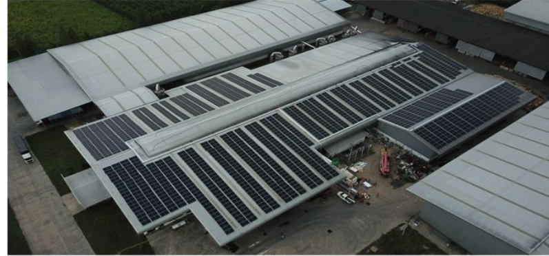
สหกรณ์กองทุนสวนยางอำเภอบ่อทอง จำกัด จังหวัดชลบุรี Capacity : 999.24 kWp Solar Rooftop
